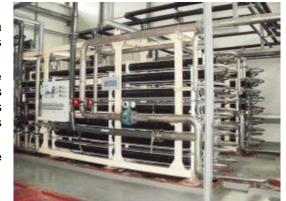
Figure 11 : station de nanofiltration du Paradis (source : SIE du Soiron)
